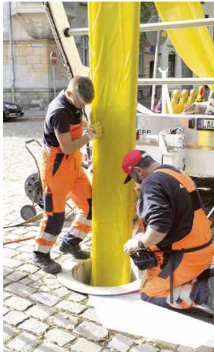
▲ Inliner-Verfahren: Dieser gelbe „Schlauch“ ist eine schützende Gleitfolie, darin eingewickelt ist ein Kunstharzmischgewebe. Mithilfe einer Seilwinde wird der Folienschlauch durch den Kanal gezogen und anschließend mit Druckluft aufgepumpt. Durch Lichteinwirkung härtet das Kunstharz aus und legt sich wie ein neuer, schützender Mantel in das Alrohr.
