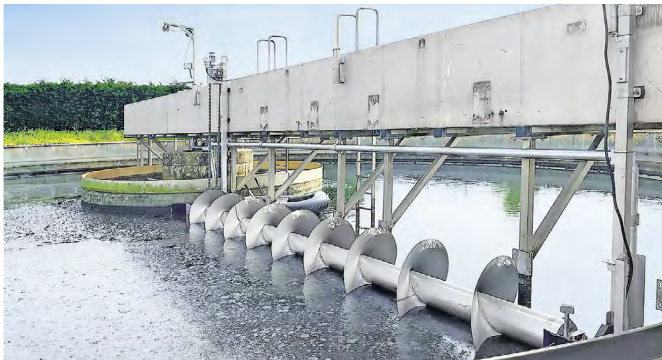
Die siebeneinhalb Meter lange Schnecke transportiert den Schwimmschlamm ab und reinigt das Wasser.
