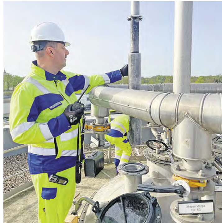
Die Firma DBI Gas- und Umwelttechnik GmbH überprüft auf dem Faulturm die Gaslanzen. Fotos (2): ZV Torgau-Westelbien
