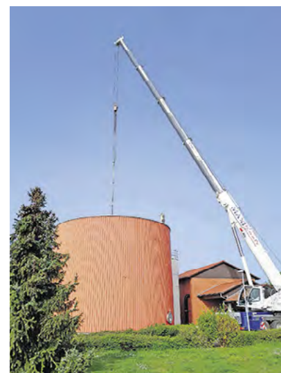
Für den Austausch der Gaslanze ist der Einsatz eines Krans notwendig.
